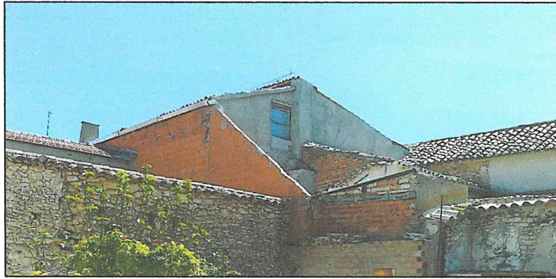
Ilustración 2. Estado del inmueble tras la paralización de las obras en marzo de 2019
